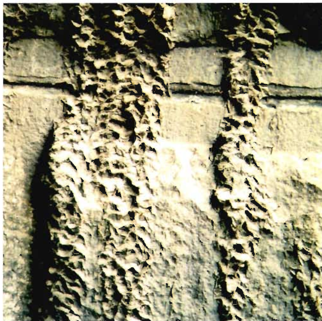
Сл. 10. Наслаге муља најложијеног са коловозне траке моста
