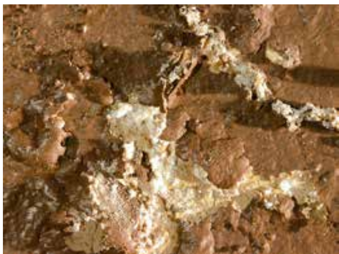
Сл. 2. Провлаживање из 1995. године, као последица новог иродора влаге. Јасно се види настајање наслага соли калцијум-сулфата испод бојеног слоја и његово љусицање
