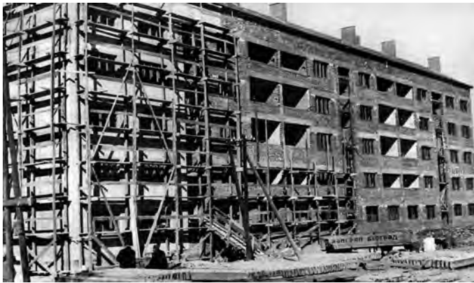
Сл. 3. Стамбени павиљони у Цвијићевој улици, Београд, изглед из 1948. (арх. Владета Максимовић)
